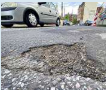
In Deutschland haben viele Straßen Schäden. FOTO: DPA
